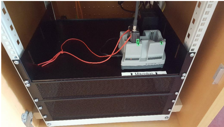
Mikrofon im Technicschrank
