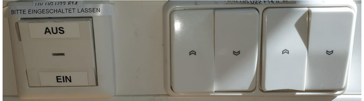
Schalter Lautsprecher und Leinwandsteuerungen im Brüstungskanal
