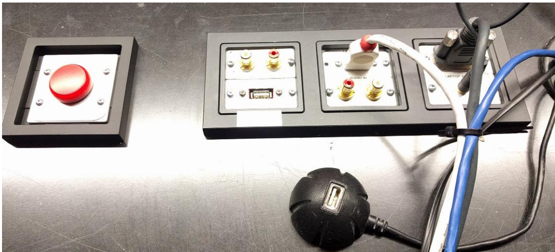
Aufnahmeleuchte Vorlesungsaufzeichnung und Pultanschlussfeld
